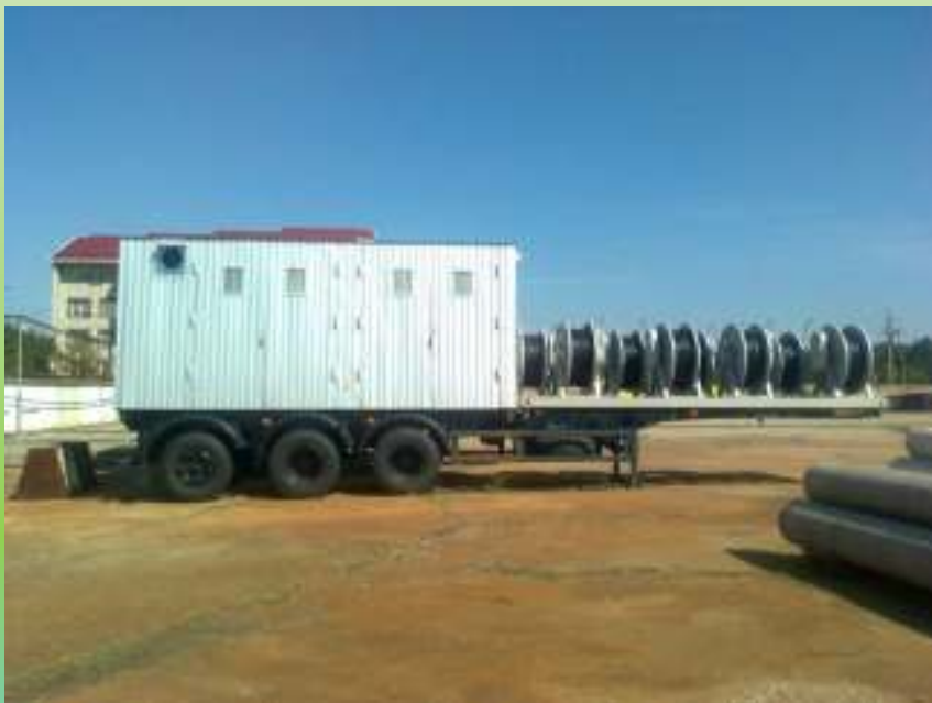
Блок электрического распределения МДГ-0,4 кВ
