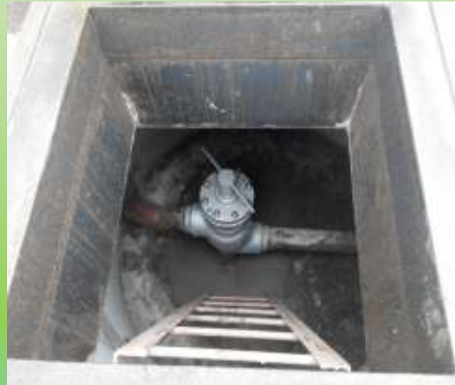
Смотровой колодец с арматурой Ду125
