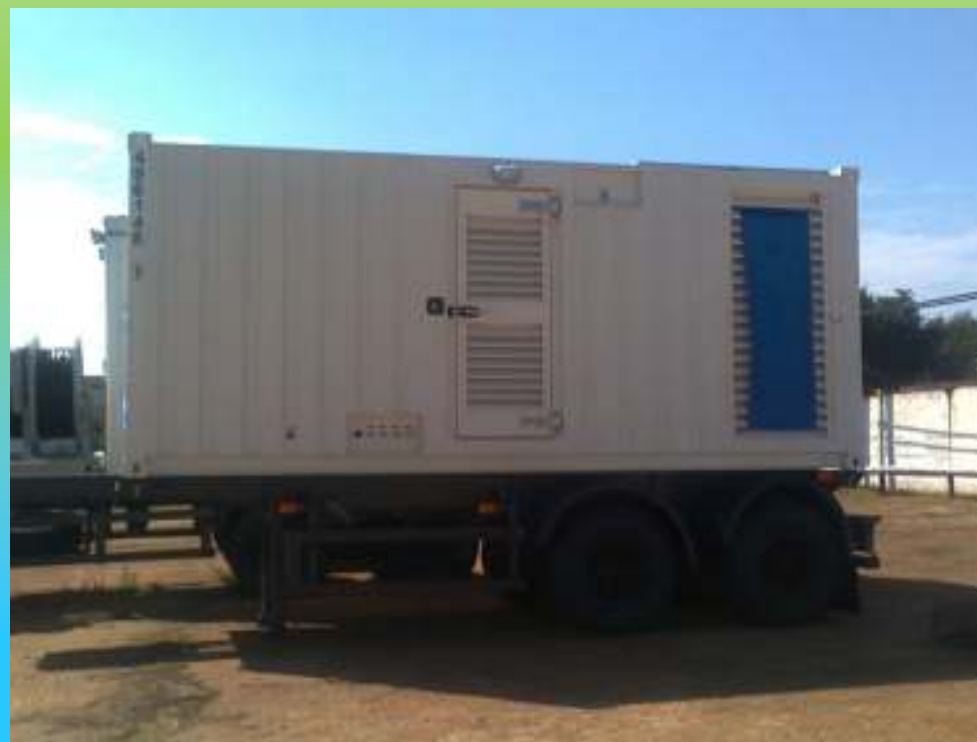
Генераторный модуль МДГ-0,4 кВ
