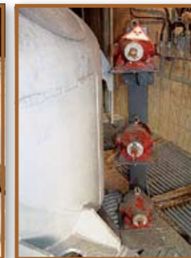
Контроль уровня заполнения бункера
