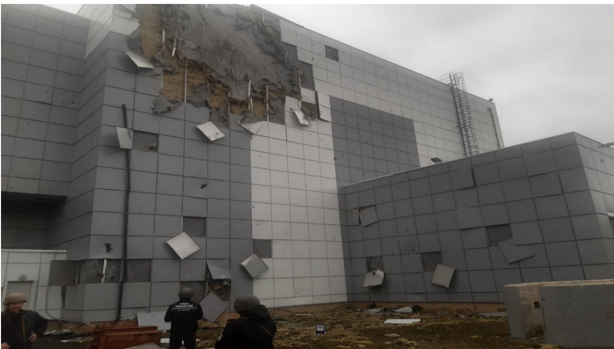
Фото 2 – Пошкодження основної будівлі ЯПУ «Джерело нейтронів»
