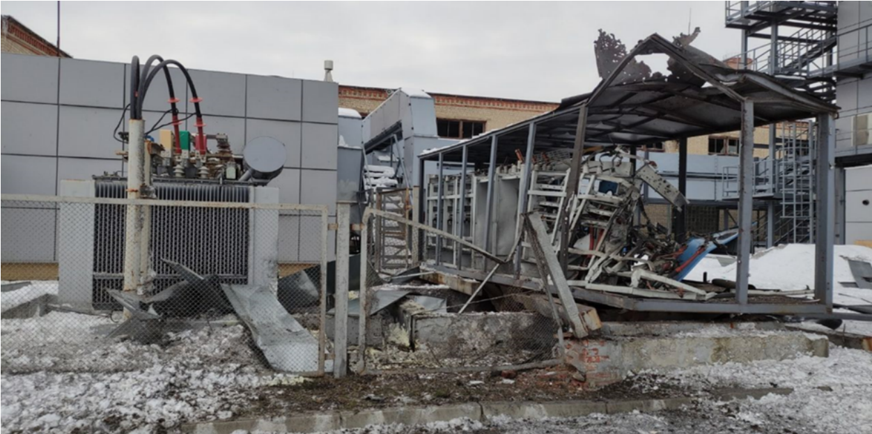
Фото 1 – Зруйнована підстанція РУ-0,4 кВ
