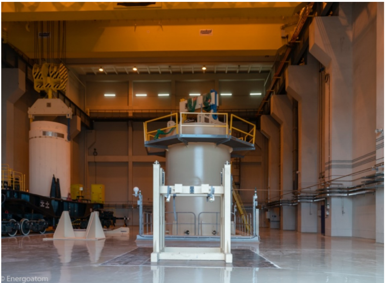
Фото 3 – Центральний зал будівлі приймання контейнерів ЦСВЯП
