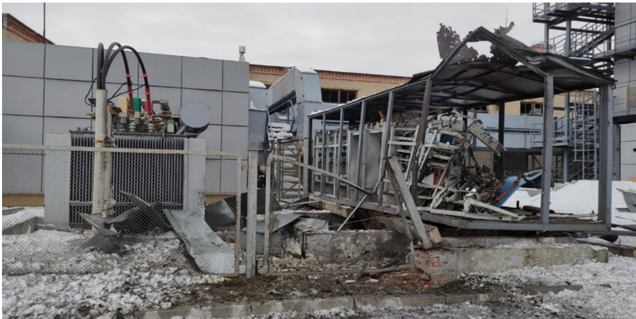
Фото 1 – Зруйнована підстанція РУ-0,4 кВ
