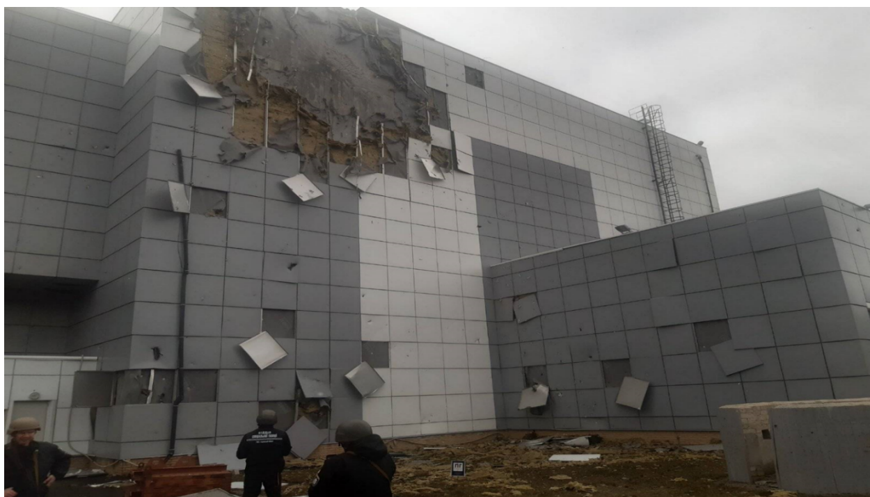
Фото 2 – Пошкодження основної будівлі ЯПУ «Джерело нейтронів»
